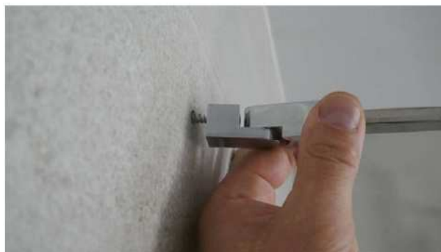
Festet til veggen er løsnet, og må festes på nytt.
