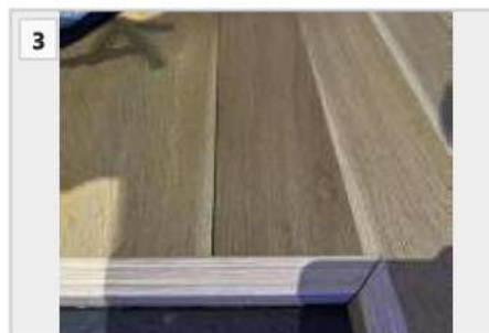
Sprekker i skjøt.
