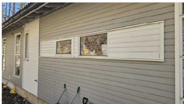
Dagens løsning ved vinduer på kjøkken.
