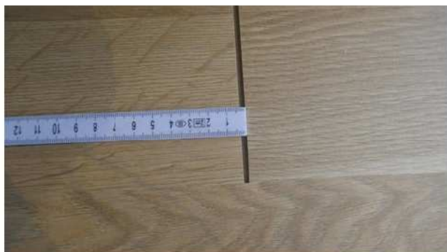
Glipper er registrert ved gang rett bak døråpning i forrige bilde.
