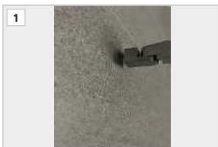
Løst feste på glassvegg. Bildet viser løst feste på glassvegg på bad.
