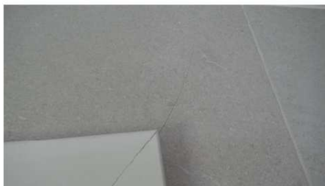
Det er observert sprekk i en flis over dør.
