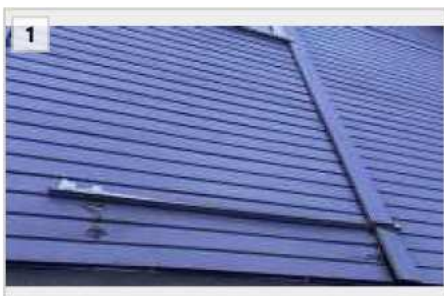
Entréttak/Baldakin etter kollaps. Bilde viser der baldakinen hang før den kollapse.
