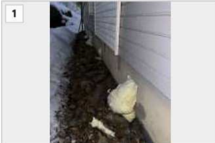
defekte ventilasjonsluker som er skummet igjen.
