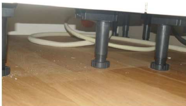
Mangelfull klamring av rør under kjøkkenbenk. Sokkel må demonteres for å kunne se forholdet.
