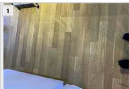
Sprekk i langsgående skjøt Bildet viser sprekk i langsgående skjøt i laminaten.
