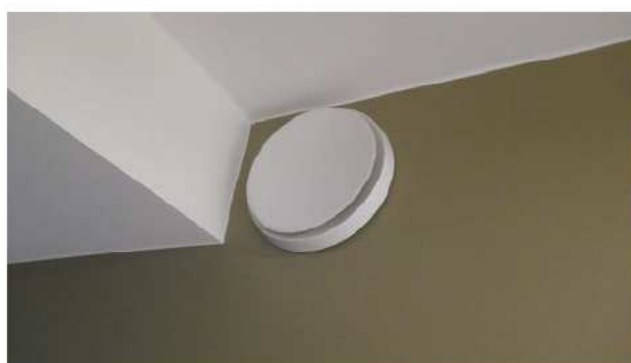
Avtrekk på kjøkken i hybel er målt til 42 m 3 /time.
