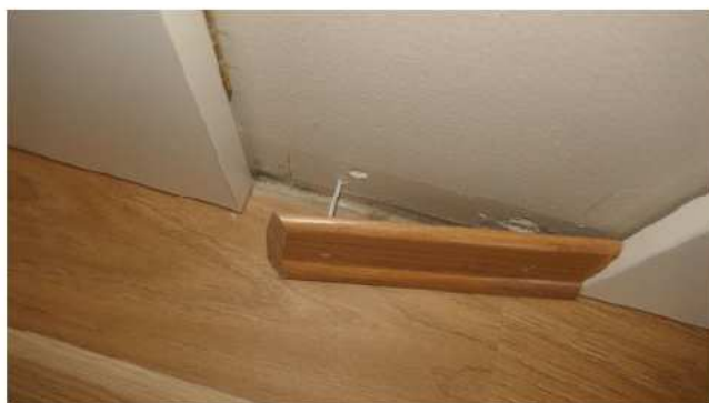
Også bak lister er det fuget.
