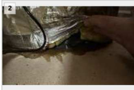
Fuktig isolasjon og vann på sponplater. Bildet viser vann på spongulv og fuktig isolasjon rundt rørføringen.
