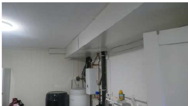
På vaskerom er det avtrekksventil i innkassing.
