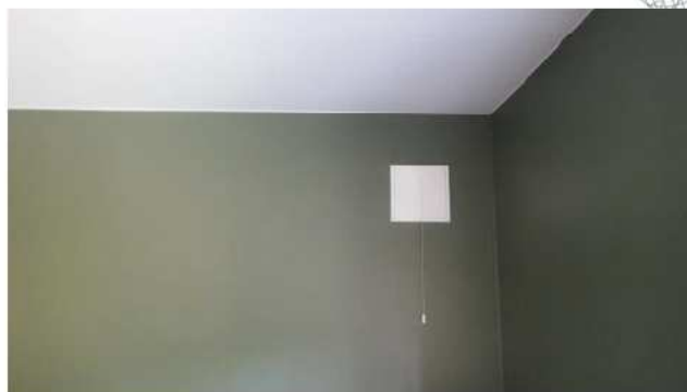
Naturlig ventilering i soverom 1 i hybel. Ventilen var stengt på befaring. Leietaker fikk beskjed om å åpne den opp og at det alltid skal stå oppe.
