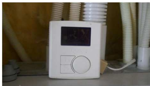
Anlegget står på normaldrift under min befaring.
