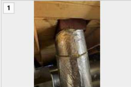
Fuktmerker på undertak Bildet viser fuktmerker på undertak ved gjennomføring av avløpsrør.
