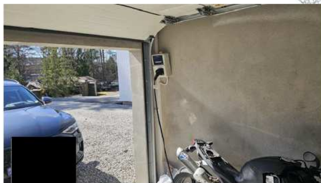
El-billader er dels løsnet fra veggen.
