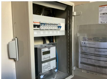
Automatsikringer i sikringsskap plassert i gang/fellesareal.
