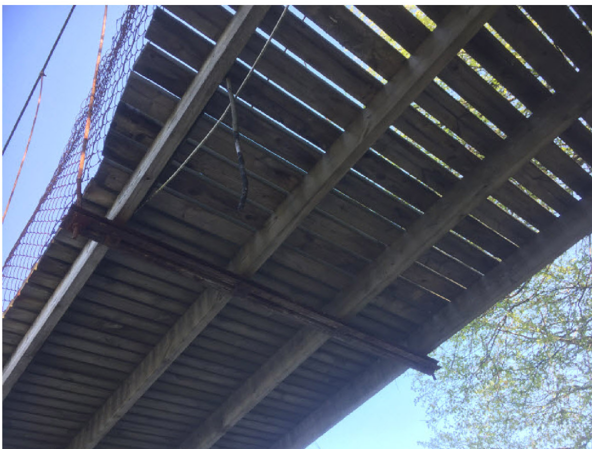
Brobane fra undersiden med 4 stk. langsgående 2"x6" Brobane bredde 2 m. CC stagoppheng 2 m.
