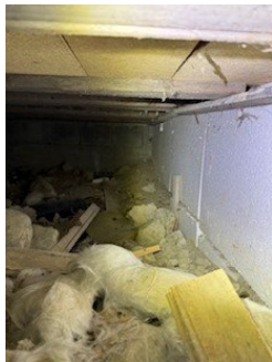
Det ligger organiske materialer direkte mot grunn som anbefales fjernet da dette gir sopp/råteskader.
