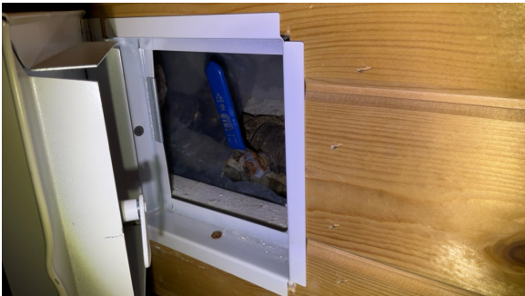
Innvendig hovedstoppekran er plassert i luke på bad i kjeller.
