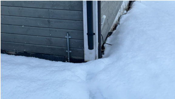
Takvannet ledes ikke vekk fra bygningen.
