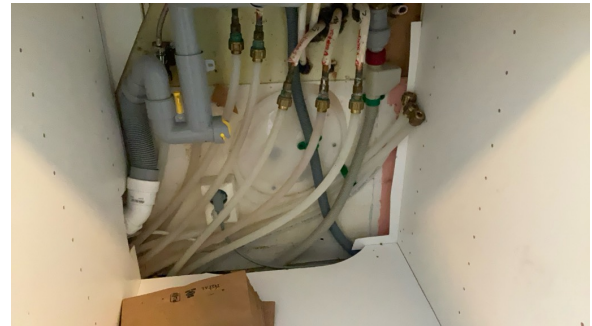
Vannrør er ikke lagt vannskadesikkert.
