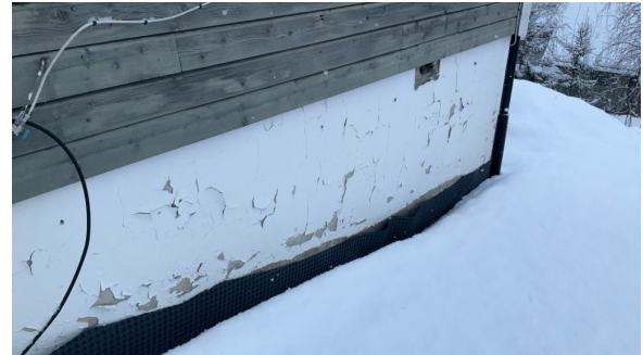
Malingsflask på grunnmuren.
