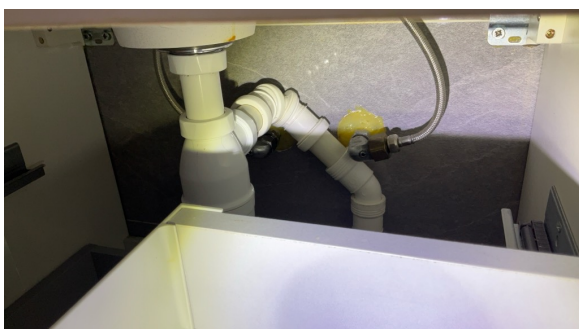
Arbeidet på våtrommet bærer preg av manglende håndverksmessig utførelse.
