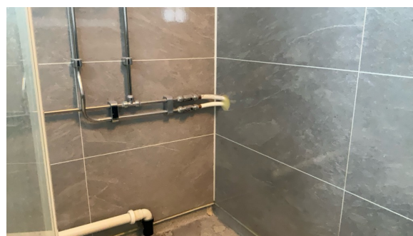
Rørgjennomføring i dusjsone er en risikoløsning.
