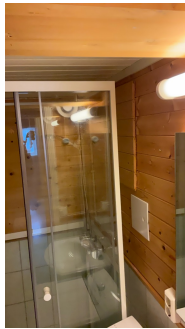
Det var ikke tilkomst til luke bak dusjkabinettet på befaringsdagen.
