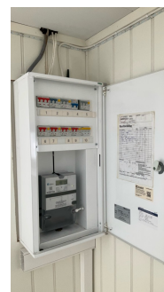
Sikringsskap plassert i soverom i 1. etasje.
