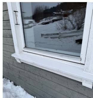
Ufagmessig utførelse rundt vinduene.
