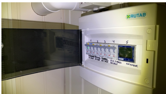
Sikringsskap plassert i gang i kjeller.
