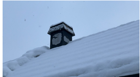
Flassing på takrenner/beslag.
