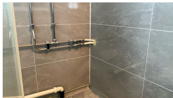
Rørgjennomføring i dusjsone er en risikoløsning.
