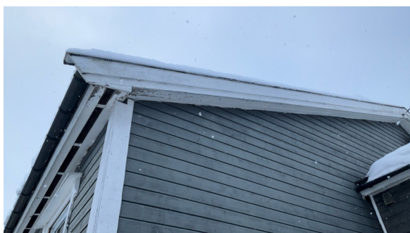
Det er påvist symptom på fukt/råteskader i takkonstruksjonen i gesimskassene.
