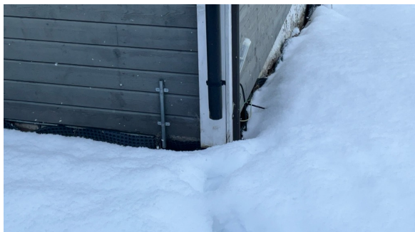
Takvannet ledes ikke vekk fra bygningen.
