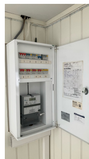
Sikringsskap plassert i soverom i 1. etasje.
