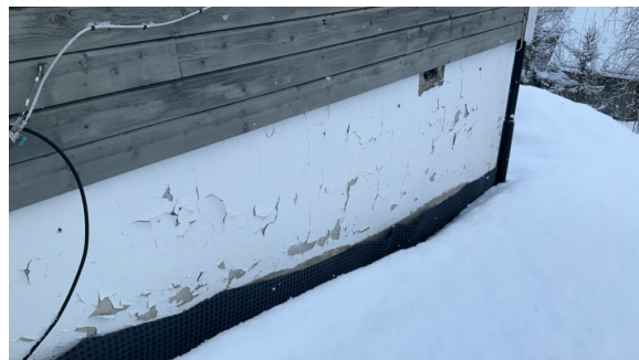
Malingsflass på grunnmuren.
