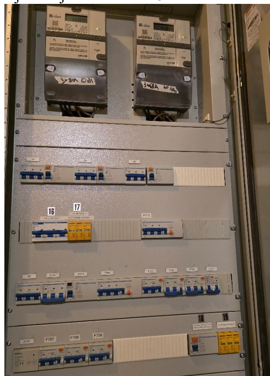
Figur 1. Sikringsskap kjeller LT3. Usikker hvor F607 går
