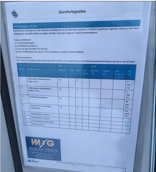
Figur 6 Kursfortegnelse WMG skur foran LT3. Inneholder stikk på stolpe 4 og 5, som mangler stikk, mangler stolpe 7, som har stikk.
