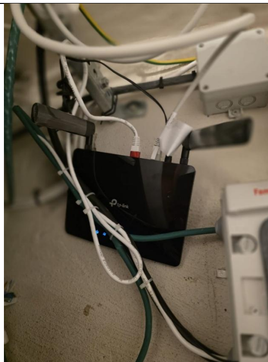
WiFi router som henger i tråder og er ikke forsvarlig montert.
