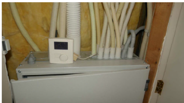
Overside av sikringsskapet i hoveddel.
