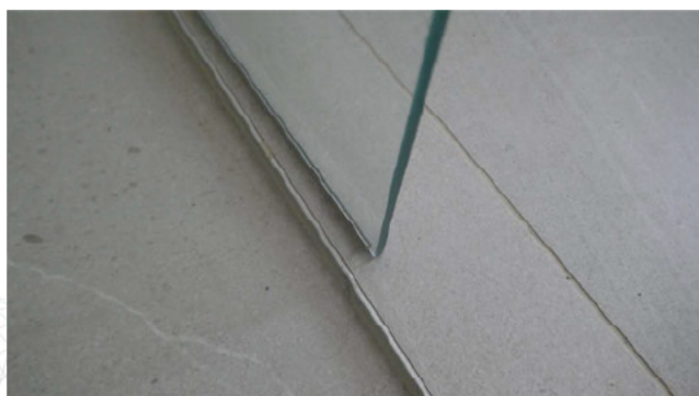
Glassveggen er løs i nedre del og kan flyttes flere cm. Fuging mellom gulv og glassvegg anbefales utført.
