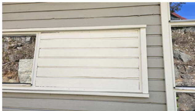
Parti av vegg der eier har opplyst om kalde partier.
