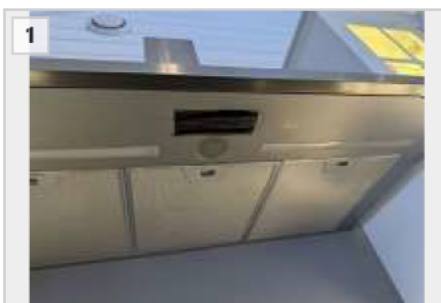
Ventilator Bildet viser Ventilator med utskjæring der det var installert komfyrvakt.
