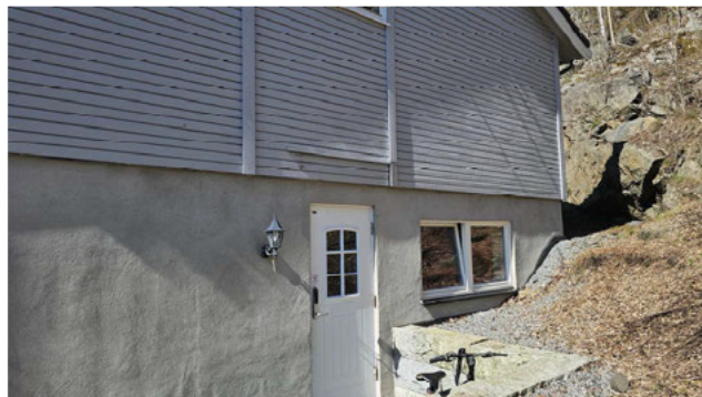
Eier opplyser at dette falt ned grunnet dårlig innfesting i veggen.
