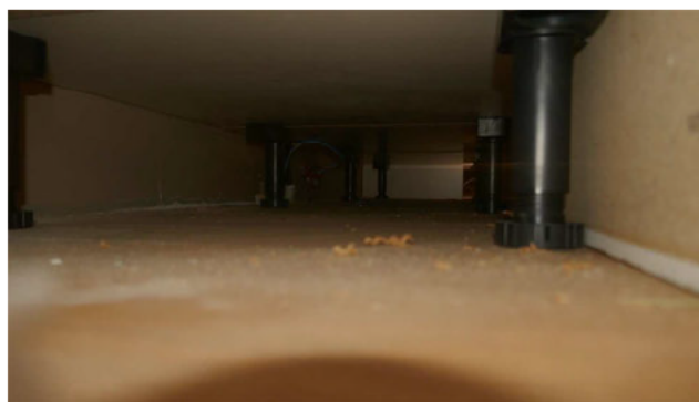
Ledninger avsluttet med Wago-klemmer under innredning. Sokkel må demonteres for å kunne se forholdet. El-takstmann bør vurdere forholdene.
