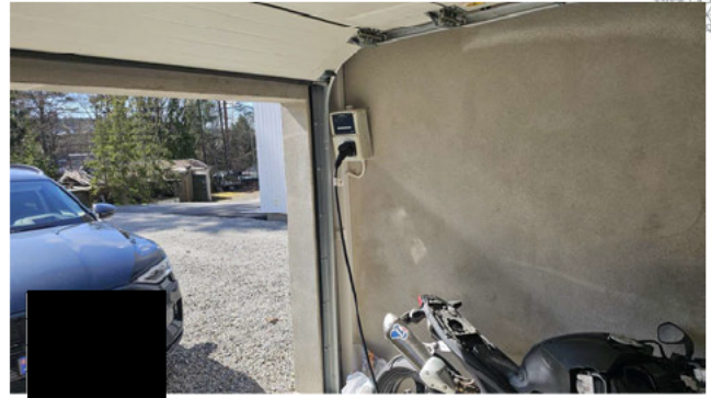
El-billader er dels løsnet fra veggen.
