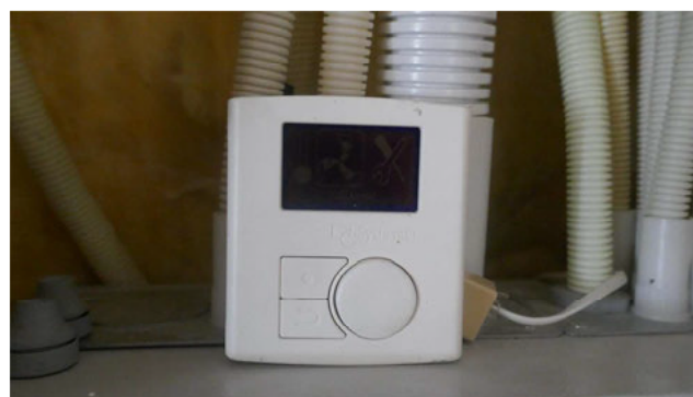
Anlegget står på normaldrift under min befaring.
