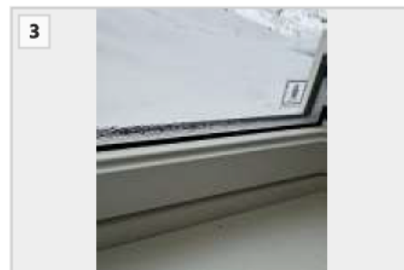
Kondens, fukt og dugg på vinduer Vinduet viser klare tegn på manglende ventilasjon.
