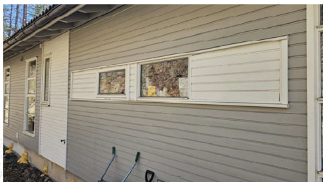
Dagens løsning ved vinduer på kjøkken.
