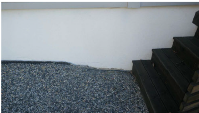
Plasten var synlig langs hele resten av veggen.
