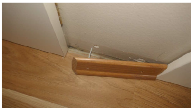
Også bak lister er det fuget.
