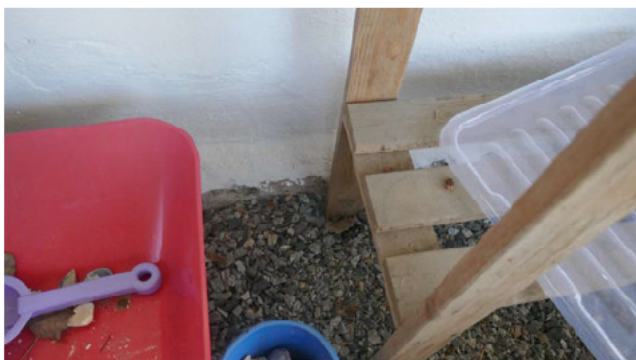
Det er ingen plast mot grunnmur under bod, og det er heller ikke behov for det.
