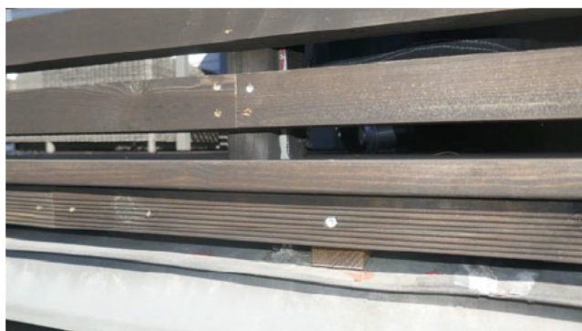
Rekkverk er festet i eldre braketter av stål. Tekkingen kunne ikke inspiseres grunnet liten klaring mellom tekking og trekonstruksjon.
