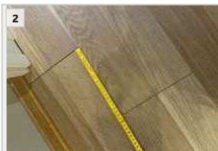
For kort avstand og sprekk. Bildet viser for kort avstand og sprekk i endeskjøt.
