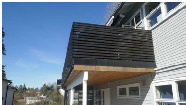
Tak med eldre tekking over inngangsparti.
