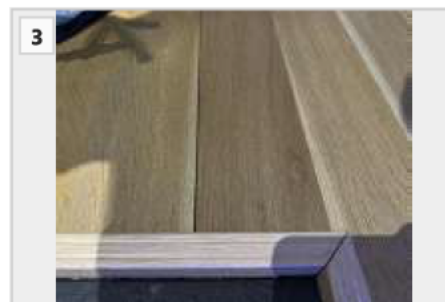
Sprekker i skjøt.
