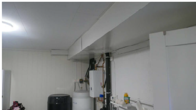
På vaskerom er det avtrekksventil i innkassing.
